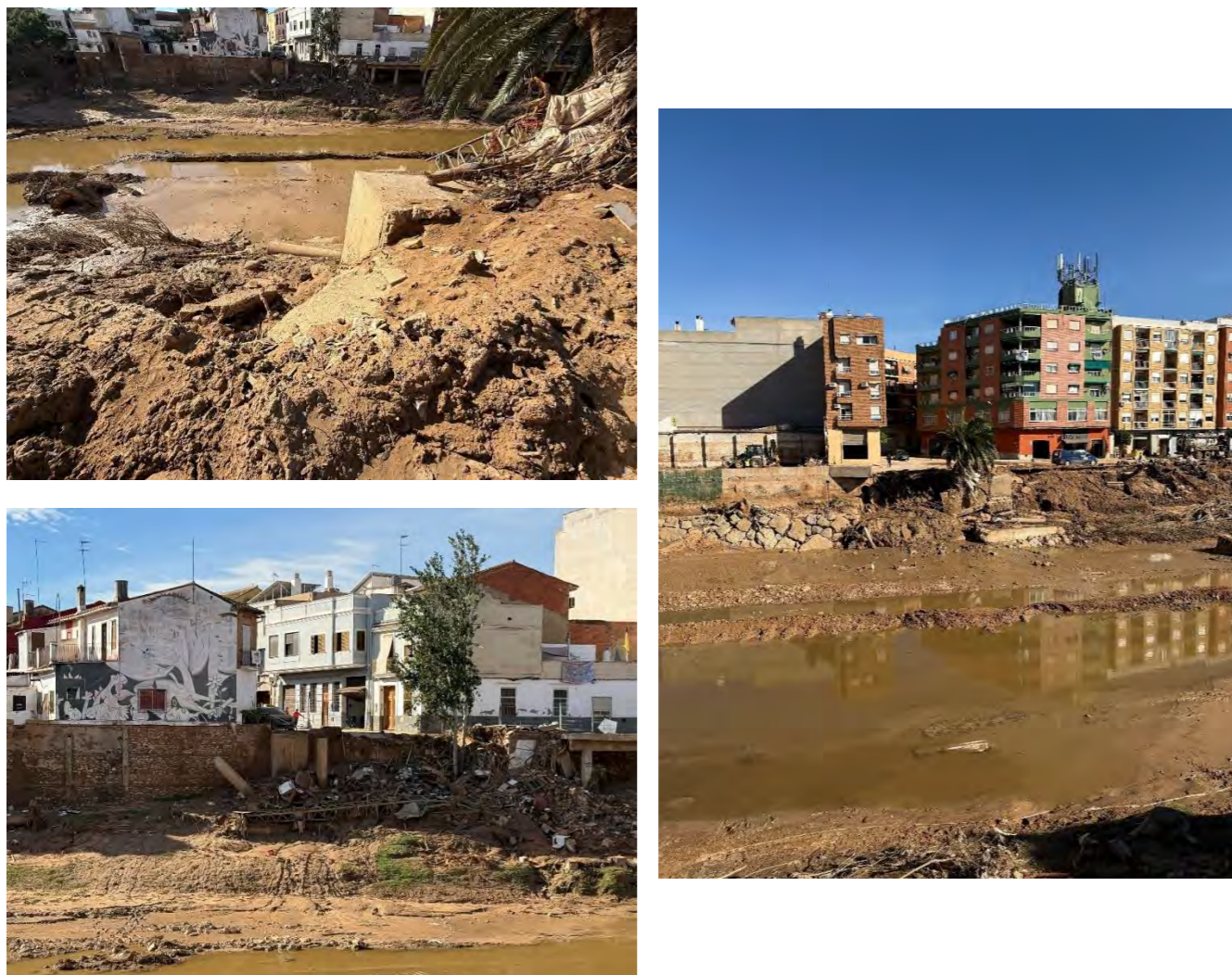
Figura 9. Vista del estribo oeste (izda) con pilas de apoyo colapsadas. Vista del estribo este (dcha) sin pilas de apoyo, que han sido arrastradas, y muro de estribo dañado.
