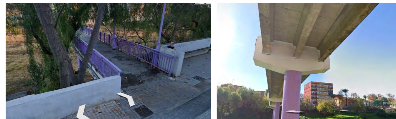
Figura 3. Pasarela Niños antes de la Dana. Estribo sur (izda) y pilas (dcha).
