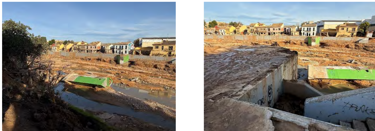
Figura 6. Pasarela Poeta Ángel González después de la DANA. Una de las pilas volcada en el cauce. Al fondo vista del muro del estribo en el margen este, que sale en promontorio respecto de la línea del margen del cauce.
